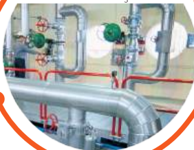
BOMBAS, IRRIGADORES E TUBULAÇÃO
